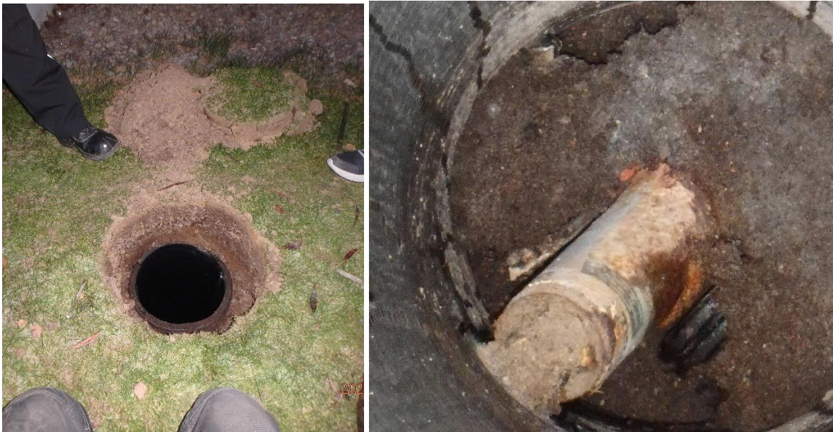
Kuva 4. Kaivon pohjalla olevista jätteistä ja maa-aineksesta huolimatta putkien taso oli nähtävissä ja kaivossa ei ollut vettä.
