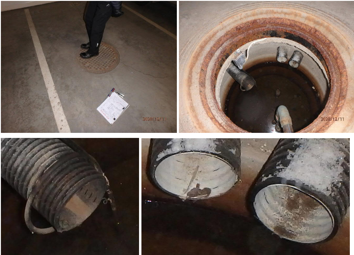
Kuva 3. Perusvesien imeytyskaivo. Kaivon tulevien salaojien päät olivat kuivia, mutta niissä näkyvän hiekan perusteella putkien kautta on aiemmin tullut vettä kaivoon, ja sen mukana on kulkeutunut hienoainesta. Kaivon reunan likaantumisen perusteella vedenpinta kaivossa oli aiemmin ollut huomattavasti korkeammalla.
